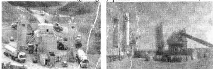
4.25-rasm. Obyektida o'rnatilgan BHS TWIN MIX 3,00 CBM markali davriy tarzda ishlaydigan betonqorgich qurilmalari
