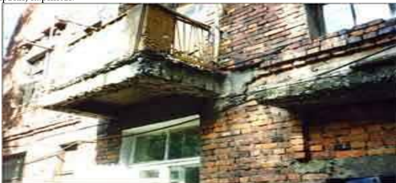
Рис. 2.1. Разрушение балконной плиты жилого дома
