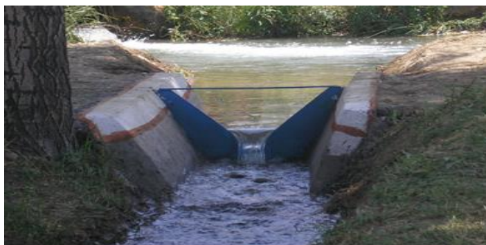
1-расм. Томсон водосливи асосидаги гидропост
