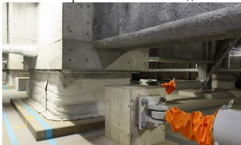
Рис. 3.20. Сейсмоизолирующие устройства из просвинцованной резины на этаже сейсмической изоляции
