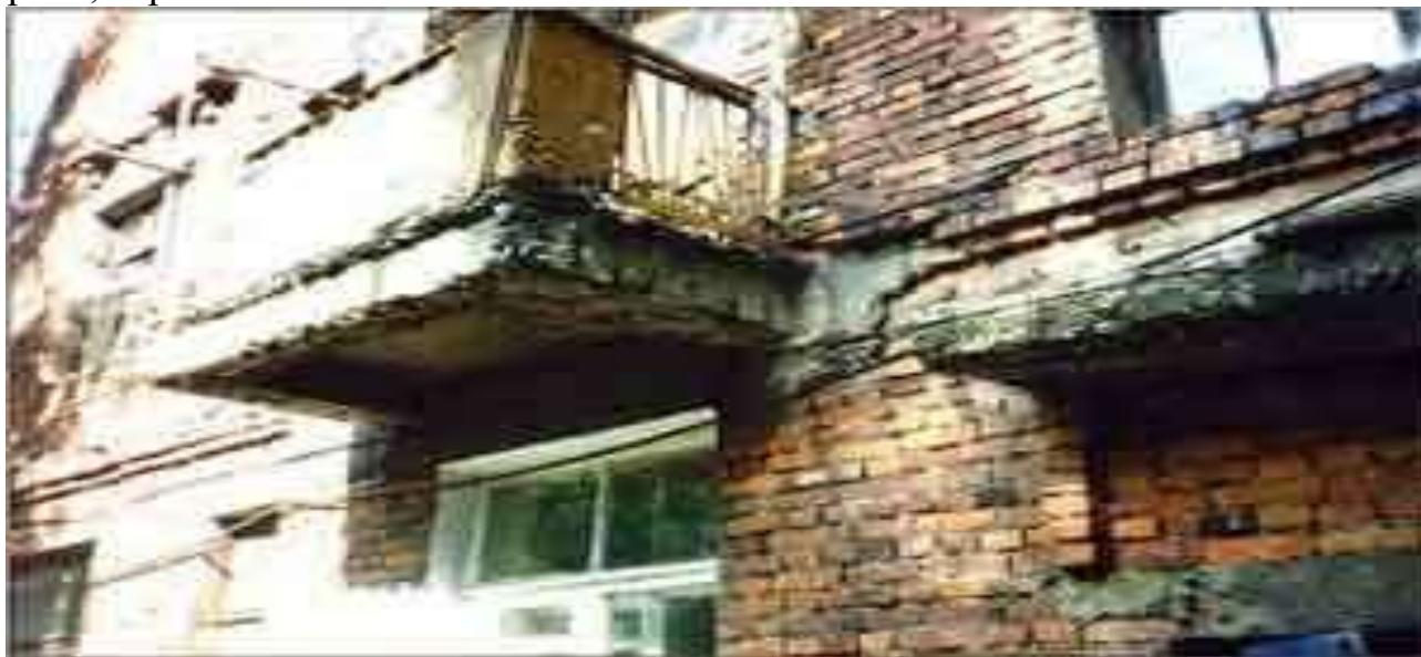
Рис. 2.1. Разрушение балконной плиты жилого дома
