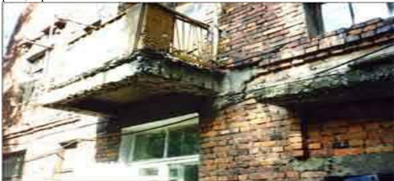
Рис. 2.1. Разрушение балконной плиты жилого дома
