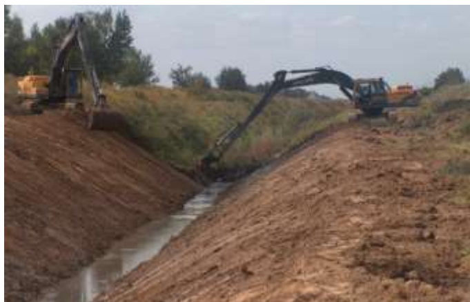
5.4- расм. Коллекторни №2 технологик схема бўйича, тескари чўмичли гидравлик экскаватор билан 2 марта ўтганда таъмирлаш-тиклаш иши кўрсатилган.
