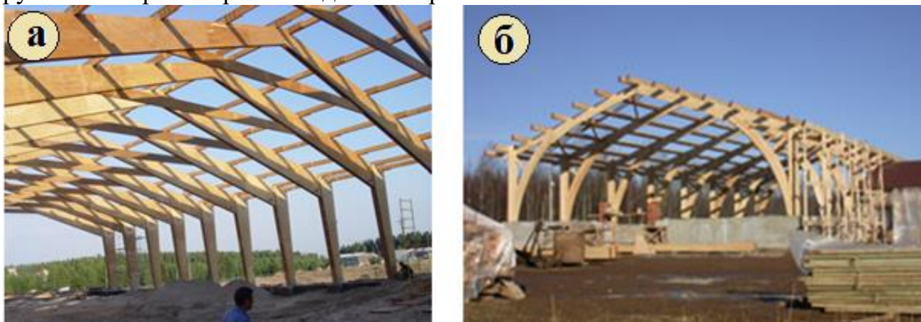
Рис. 2.28. Деревянные рамы зданий: а – с монтажным сопряжением ригеля и стойки; б – из гнутой древесины
