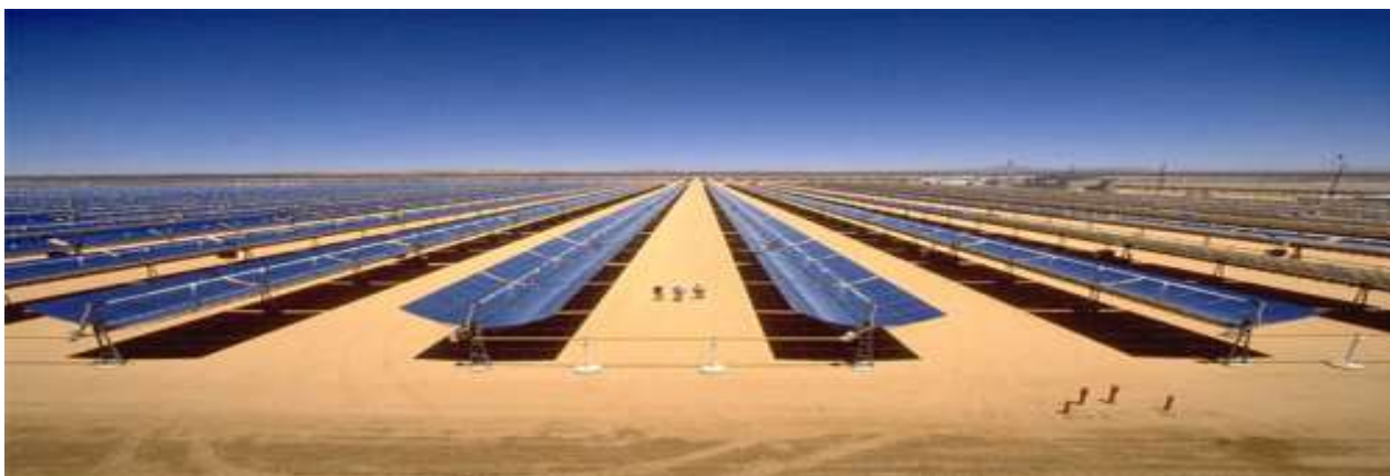
6 -расм. Дунёдаги энг катта қуёш электростанцияси.
