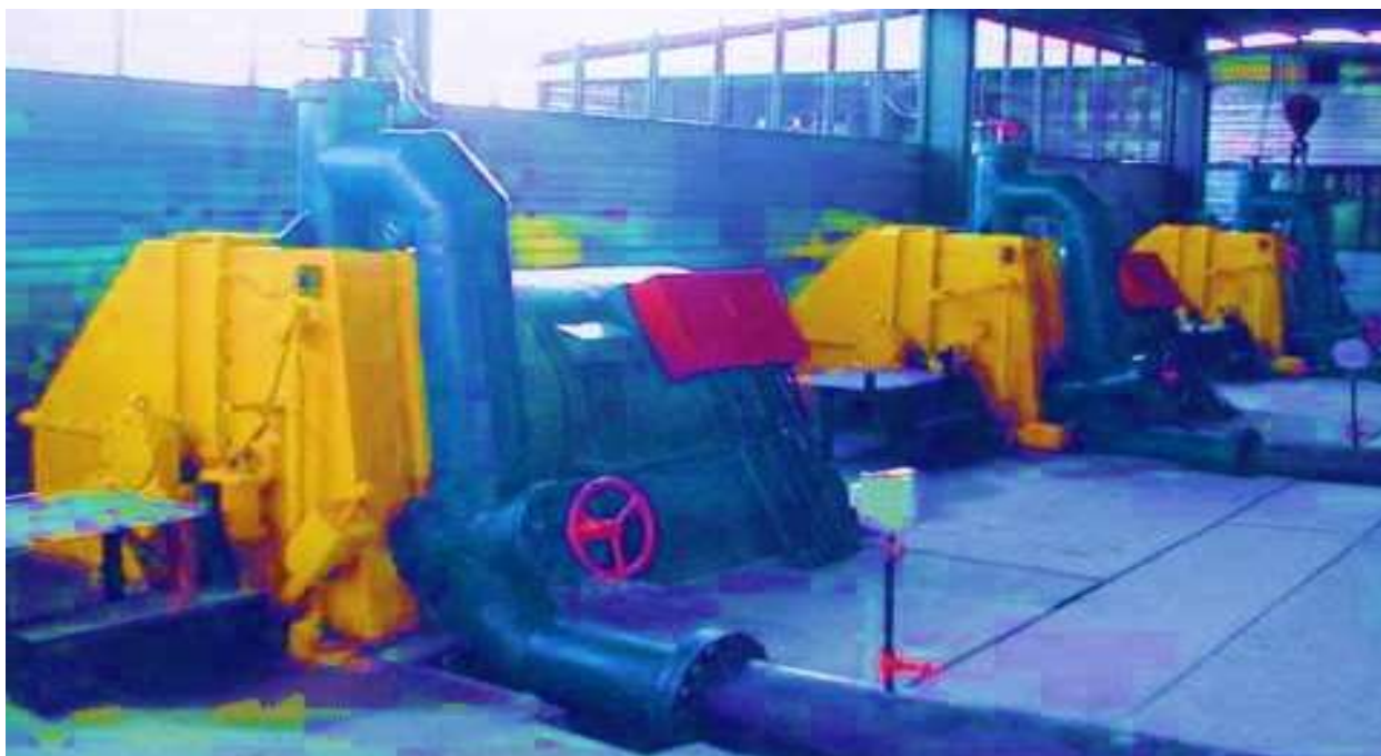
64-расм. Вертикал ўрнатилган чўмичли иш ғилдиракли кичик ГЭС машина залининг кўриниши.
