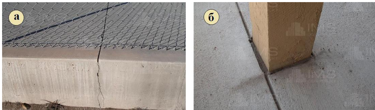
Рис. 1.26. К устройству усадочных швов: а – растрескивание в монолитной конструкции при отсутствии шва; б – зачеканенный усадочный шов в конструкции монолитного железобетонного перекрытия
