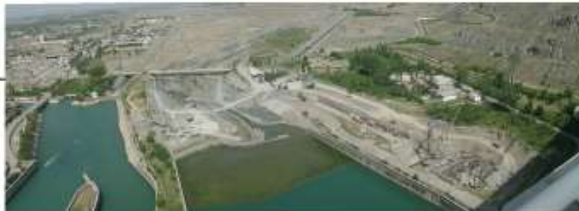
Фото 1. Строительство малой ГЭС, котлован под здание ГЭС, отводящий канал с выпуском в р. Карадарья, докер под р. Карадарья с подключением к каналу Шархонсай.
