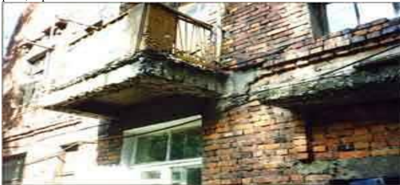
Рис. 2.1. Разрушение балконной плиты жилого дома
