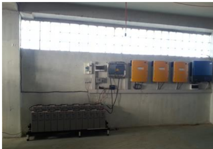
43-расм. 20 кВт қувватли ФЭС энергетик бошқарув блоки ва назорат қурилмалари
