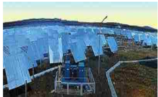
2.4-расм. Қрим қуёш электр станцияси.
