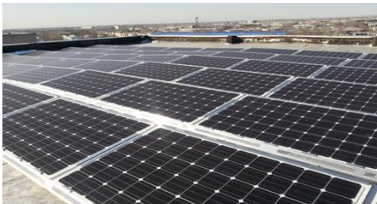
42-расм. 20 кВт қувватли қуёш фотоэлектрик станциясининг умумий кўриниши
