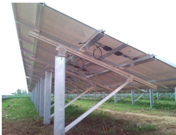
49-расм. Бир ўқли трекерга эга қуёш фотоэлектрик станцияси
