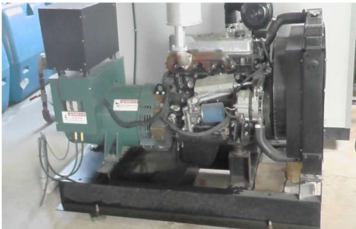
5.13-расм. Теплицада резерв автоном энергия манбаси (35 кВт ли дизел генератори)
