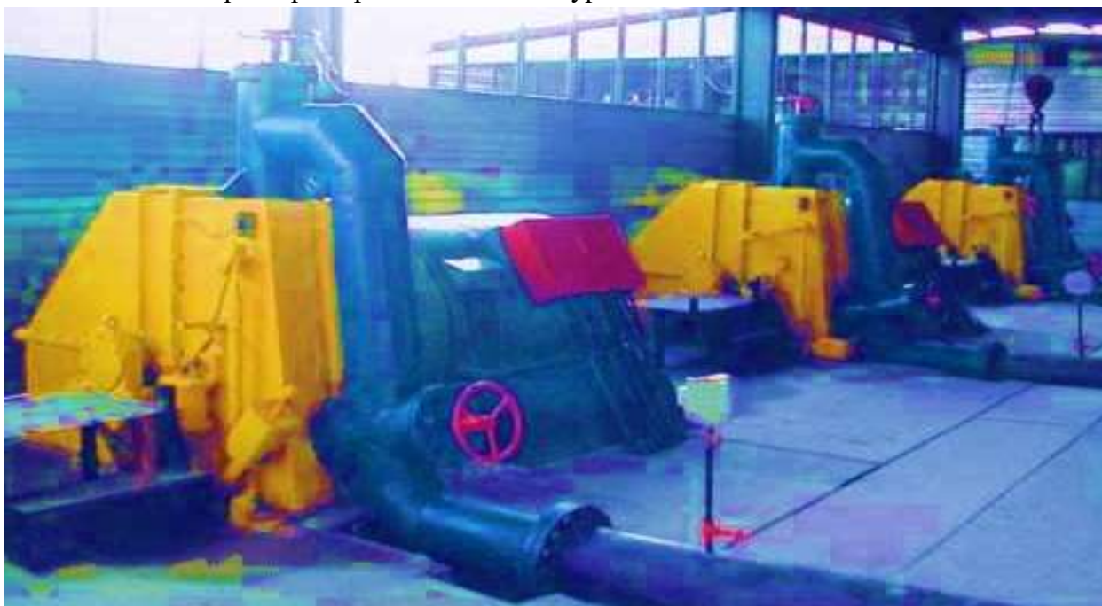
4.13-расм. Вертикал ўрнатилган чўмичли иш ғилдиракли кичик ГЭС машина залининг кўриниши.
