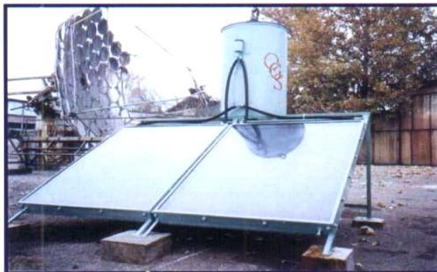
2.13-расм. Қуёш иситгичининг сатҳи 4 \text{ м}^2 ва иссиқ сув жамловчи бакининг ҳажми 300 л бўлган 2 контурли сув иситгич қурилма
