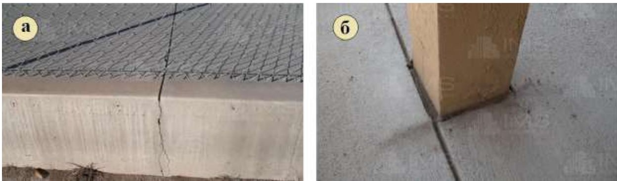
Рис. 1.26. К устройству усадочных швов: а – растрескивание в монолитной конструкции при отсутствии шва; б – зачеканенный усадочный шов в конструкции монолитного железобетонного перекрытия
