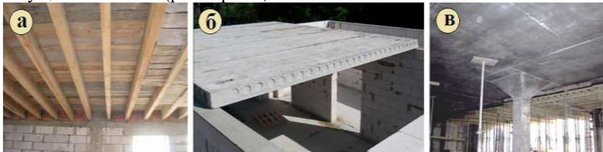
Рис. Пр1.51. Виды перекрытий по конструктивному решению: а – балочное; б – плитное; в – безбалочное
