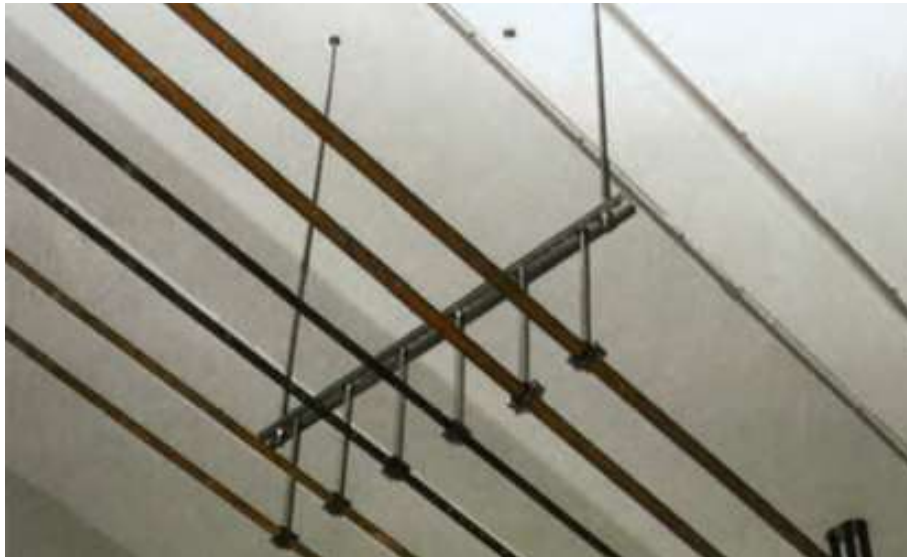
Рис. 3.23. Подвеска трубопроводов, обеспечивающая возможность их трёхмерного перемещения
