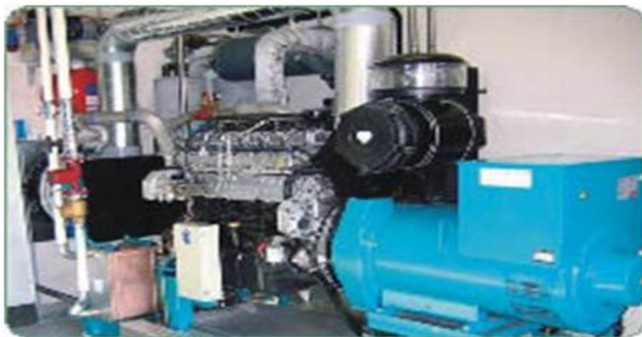
Kogeneratsion issiqlik elektrostansiya
