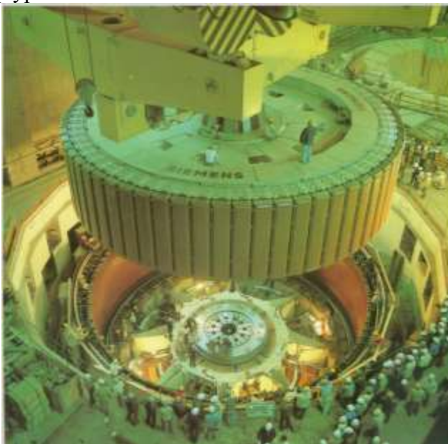
3.6 – расм. Энг катта Итайпу ГЭС генератори тасвири.
