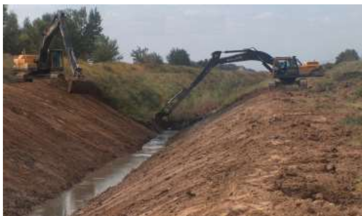
4- расм. Коллекторни №2 технологик схема бўйича, тескари чўмичли гидравлик экскаватор билан 2 марта ўтганда таъмирлаш-тиклаш иши кўрсатилган.
