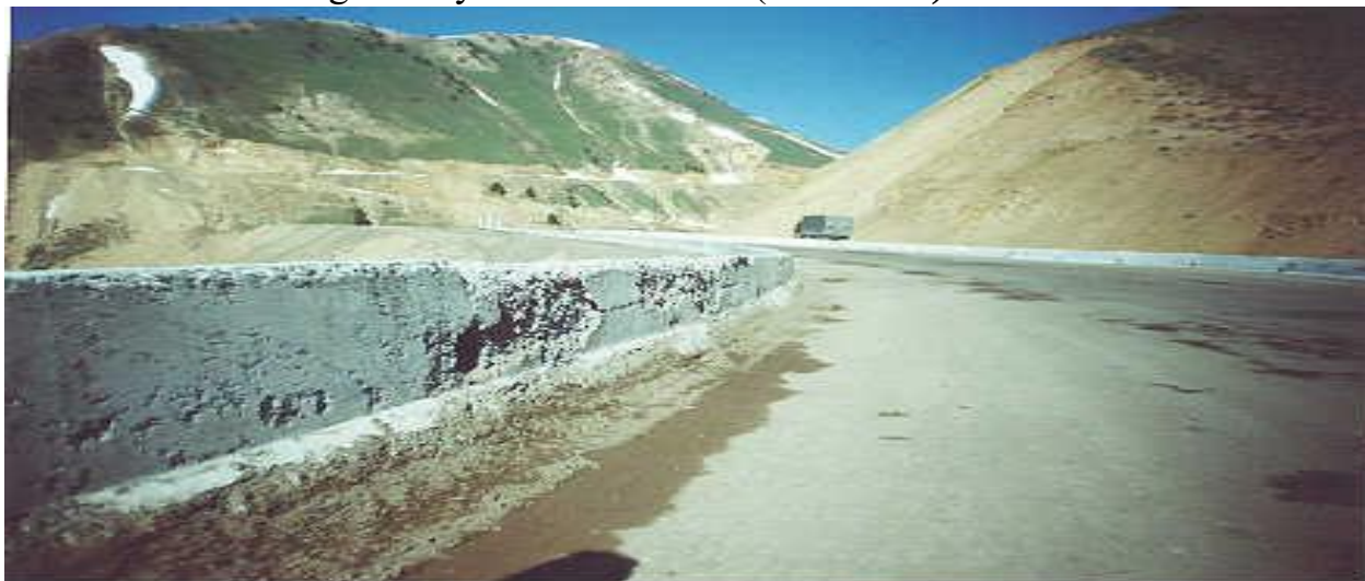
4.11-rasm. Tuzning beton to‘siqlarga ta’siri (A-373 «Toshkent-O‘sh» avtomobil yo‘lining 158 km)
