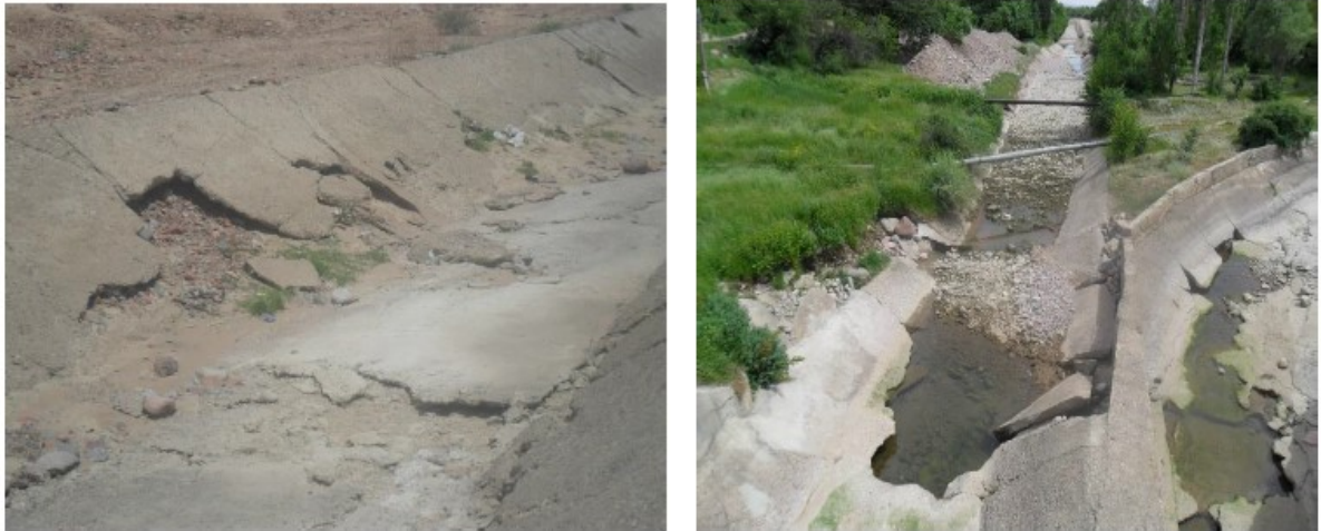
1.7-rasm. Jiyyalisoy kanali qoplamasining deformatsiyalangan holati.
