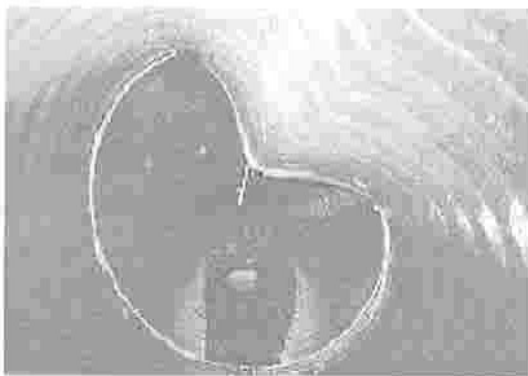
Труба из полиэтилена высокого давления после 10 лет эксплуатации
