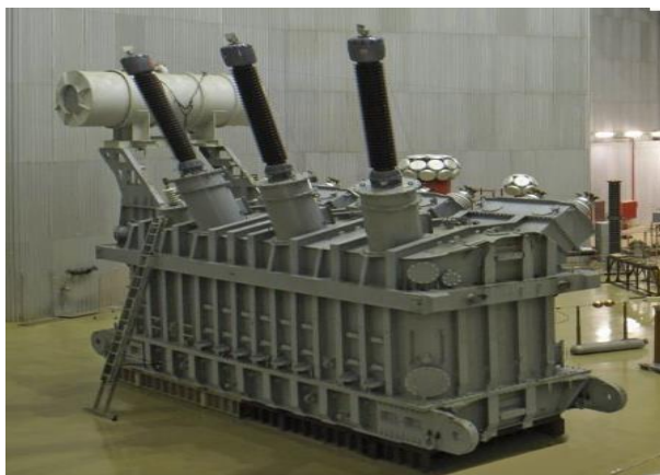
1 – rasm. TII-630000/330 tipli kuch transformatori zovodning tajriba zalida
