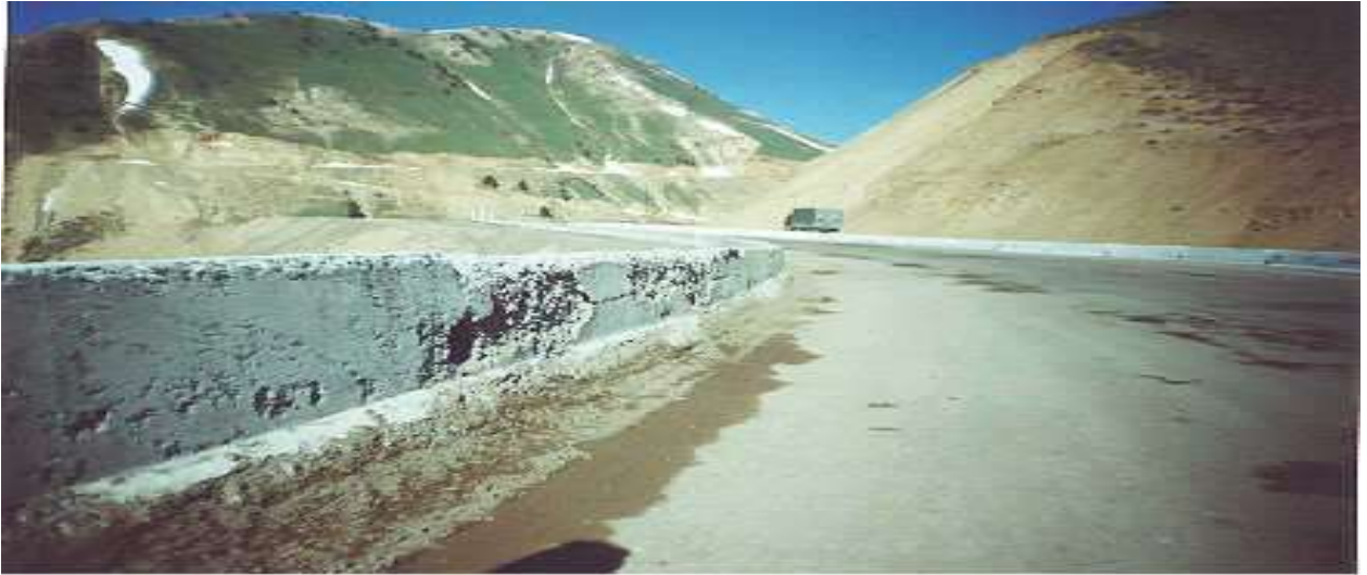
5.11-rasm. Tuzning beton to'siqlarga ta'siri (A-373 «Toshkent-O'sh» avtomobil yo'lining 158 km)
