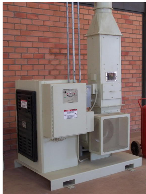
1 MBTU gaz bilan ishlaydigan burner / ventilyator majmuasi
