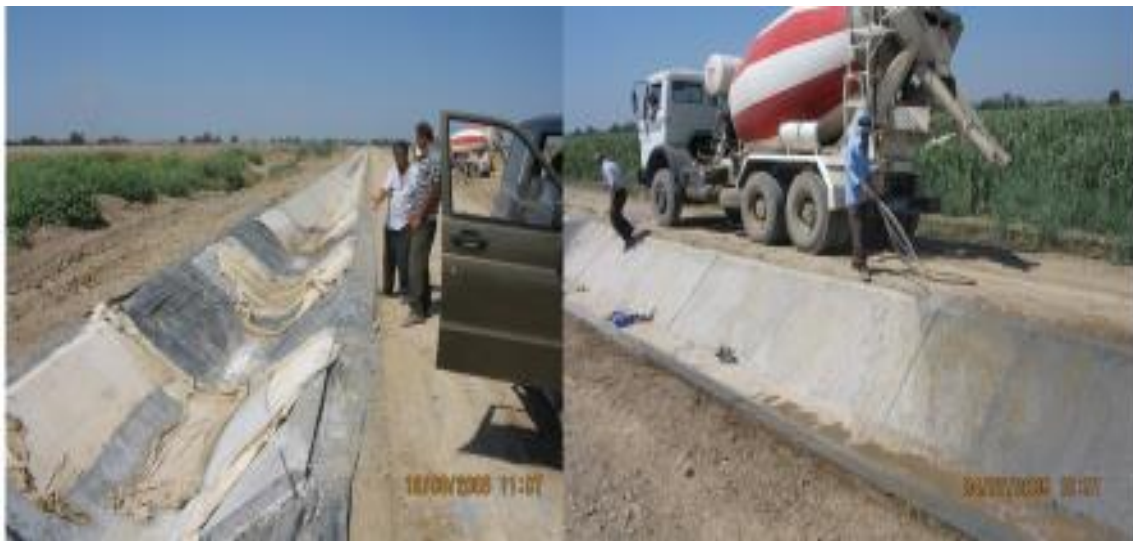
3.14 - расм. Қуйилган бетонга техник қаров ишларини амалга ошириш а) янги қуйилган бетон қопламада биринчи 3 кунгача ўтказиладиган қаров; б) янги қуйилган бетонга 3 ... 7 кун ичида ўтказиладиган техник қаров; 1 – қоплама устига ётқизилган бўз мато; 2 – автобетонқорғич ёрдамида қоплама юзасини намлаш.
