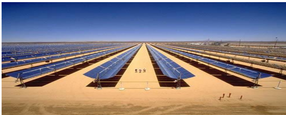
1.6 -расм. Дунёдаги энг катта қуёш электростанцияси.
